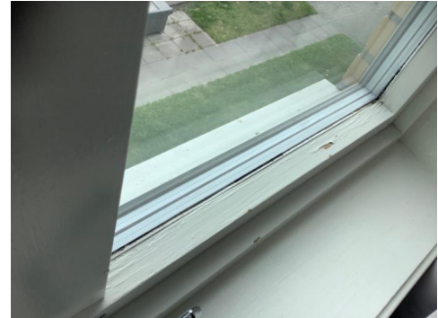
Kondensskade på vinduskarm soverom.
