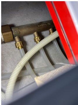
Samlestokk og nyere plastledninger i wc-kasse.
