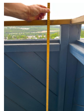
Rekkverk lavere enn dagens krav 1m.
