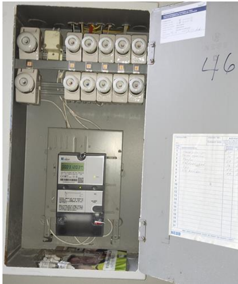
Elektrisk anlegg - [Sikringskap]
