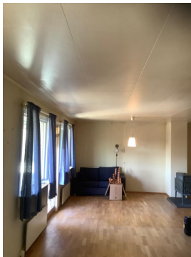
Generelt slitte overflater parkett.
