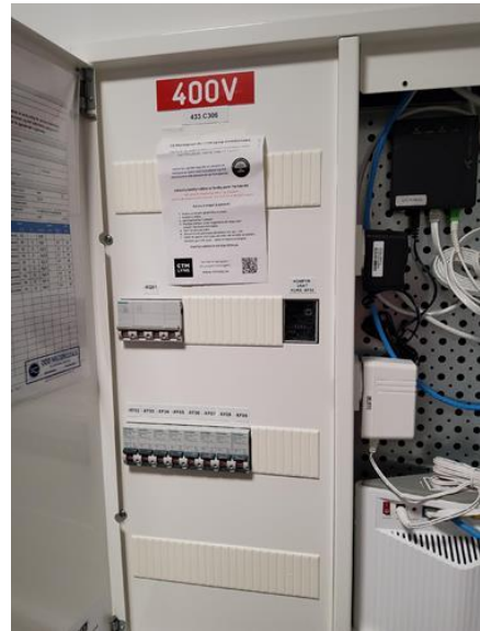
Elektrisk anlegg - [Sikringskap ]
