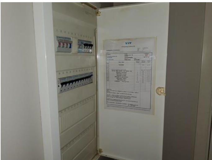
Elektrisk anlegg - [Kursfortegnelse.]
