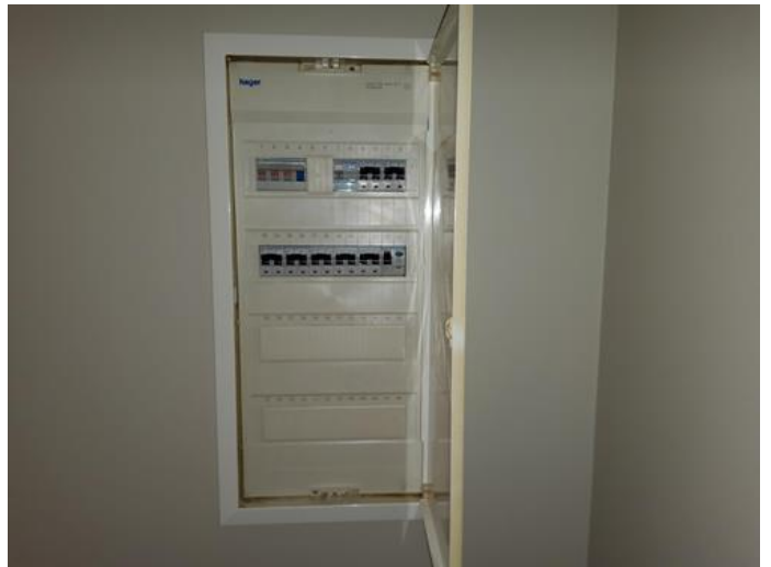
Elektrisk anlegg - [Sikringskap.]
