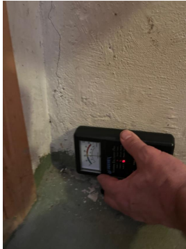
Indikasjoner fuktopptrekk nedre del av kjellervegger.
