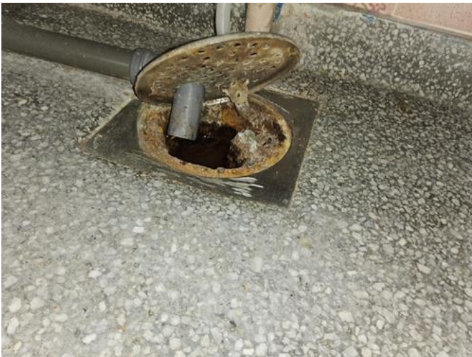
Avløpsrør (ink. sluk) - [Sluk bad]
