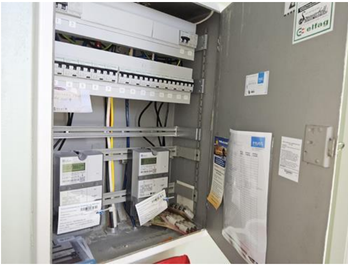
Elektrisk anlegg - [Sikringskap]
