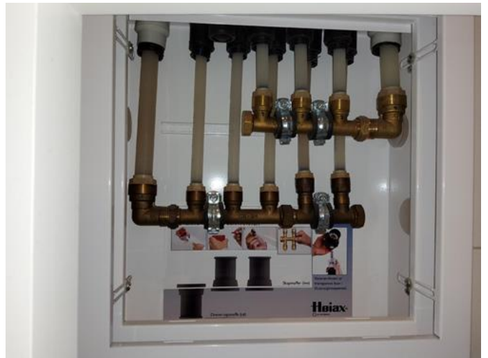
Tekniske anlegg, VVS anlegg (Sjekkpunkter utover det som er inkludert i andre rom) - [Fordelerskap for rør-i-rør-systemet]
