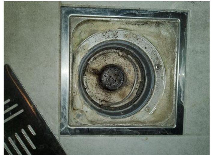
Tekniske anlegg, VVS anlegg (Sjekkpunkter utover det som er inkludert i andre rom) - [Sluk på tekniskrom ]
