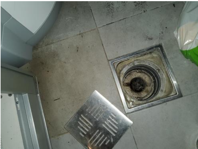
Tekniske anlegg, VVS anlegg (Sjekkpunkter utover det som er inkludert i andre rom) - [Sluk på tekniskrom ]
