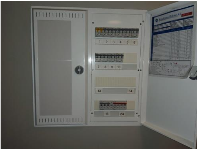
Elektrisk anlegg - [Sikringskap ]
