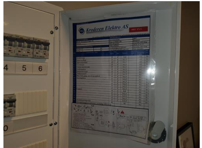
Elektrisk anlegg - [Kursfortegnelse ]
