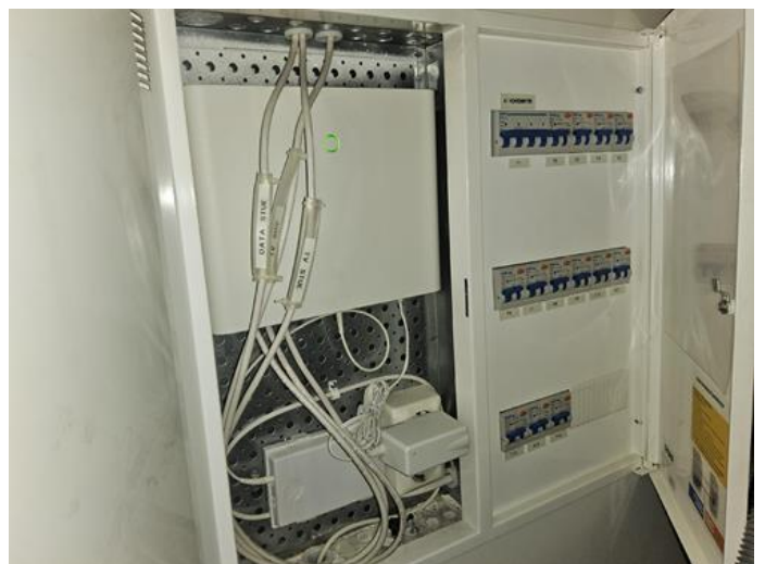
Elektrisk anlegg - [Sikringskap]
