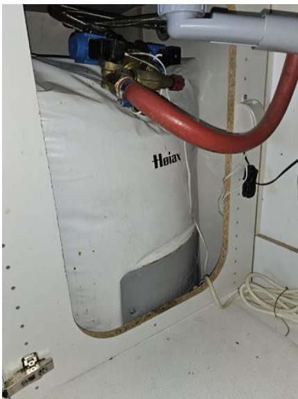
Varmtvannsbereder (Sjekkpunkter utover det som er inkludert i andre rom) - [Varmtvannsbereder]
