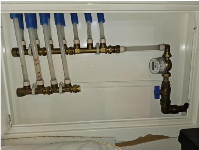
Tekniske anlegg, VVS anlegg (Sjekkpunkter utover det som er inkludert i andre rom) - [Fordelerskap for rør-i-rør system og stoppekran]
