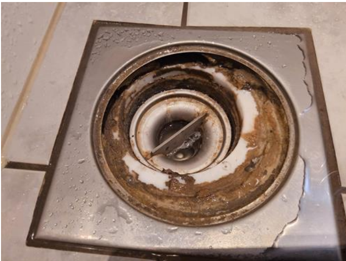
Avløpsrør (ink. sluk) - [Sluk baderom]
