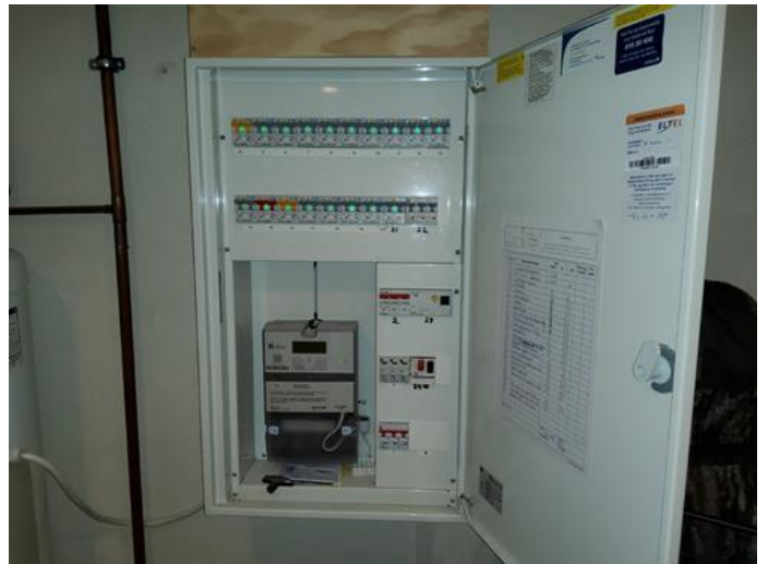
Elektrisk anlegg - [Sikringsskap.]
