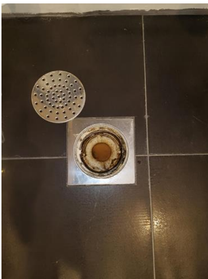
Membran, tettesjikt og overgang til sluk. - [Sluk Vaskerom, ved bereder. ]
