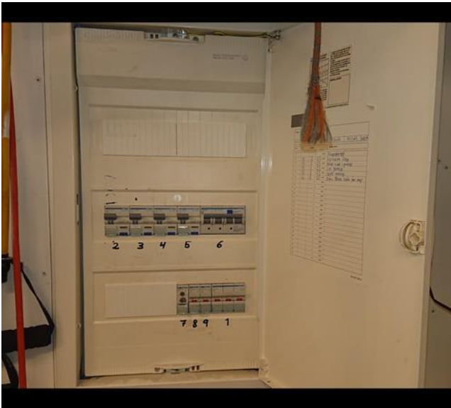
Elektrisk anlegg - [Sikringsskap Garasje.]
