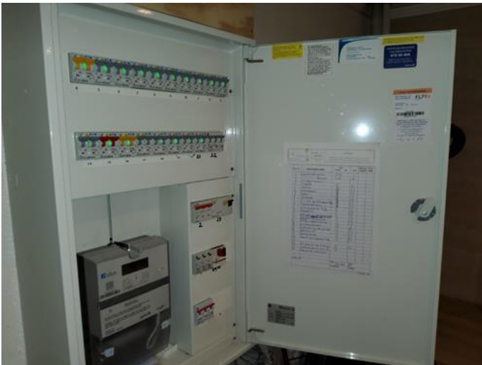
Elektrisk anlegg - [Kursfortegnelse.]
