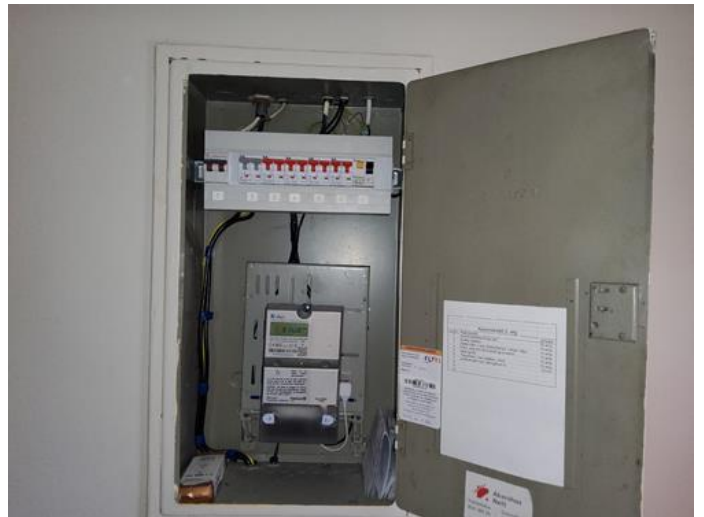
Elektrisk anlegg - [Sikringsskap 2.etasje.]
