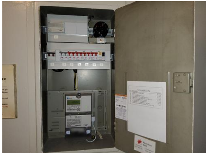
Elektrisk anlegg - [Sikringsskap 1.etasje.]
