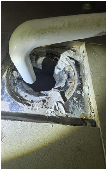
Avløpsrør (ink. sluk) - [Sluk på bad]
