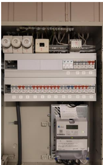
Elektrisk anlegg - [Sikringskap]
