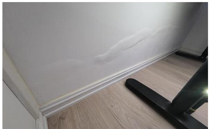
Konstruksjoner (tilfarergulv, himling og vegger). - [Fukt i kjellervegg]
