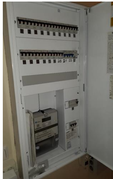
Elektrisk anlegg - [Sikringskap]
