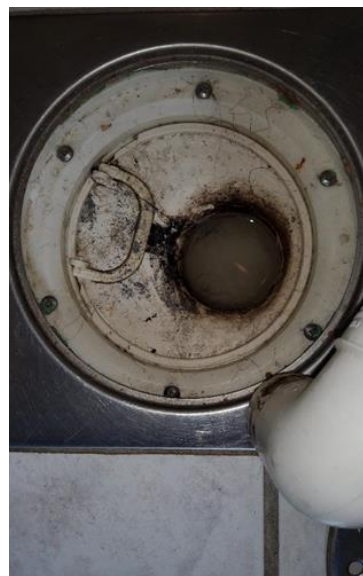
Membran, tettesjikt og overgang til sluk. - [Sluk vaskerom/bad]
