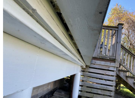
Lite lufting på panel for tilbygget
