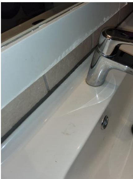
Sanitærutstyr / innredning - [Baderomsinnredning med høy slitasjegrad. ]
