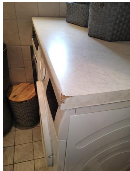
Sanitærutstyr / innredning - [Baderomsinnredning med høy slitasjegrad. ]
