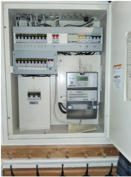
Elektrisk anlegg - [Sikringskap ]
