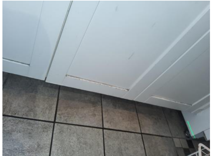
Sanitærutstyr / innredning - [Baderomsinnredning med høy slitasjegrad. ]
