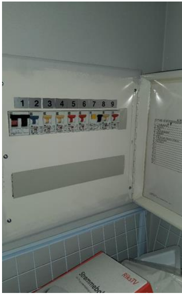
Elektrisk anlegg - [Sikringskap ]
