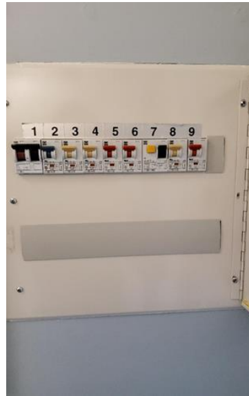
Elektrisk anlegg - [Sikringskap ]
