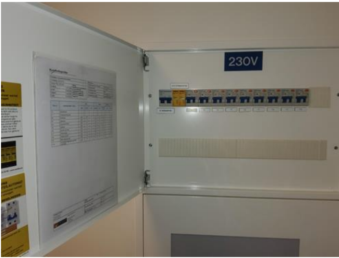
Elektrisk anlegg - [Sikringskap ]
