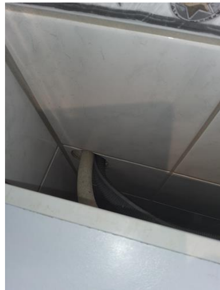
Membran, tettesjikt og overgang til sluk. - [Rørgjennomføring ved vaskemaskin. ]
