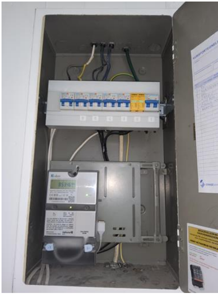
Elektrisk anlegg - [Sikringskap ]
