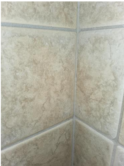
Overflater vegger - [Elastiske flisfuger har stedvis manglende vedheft bad]
