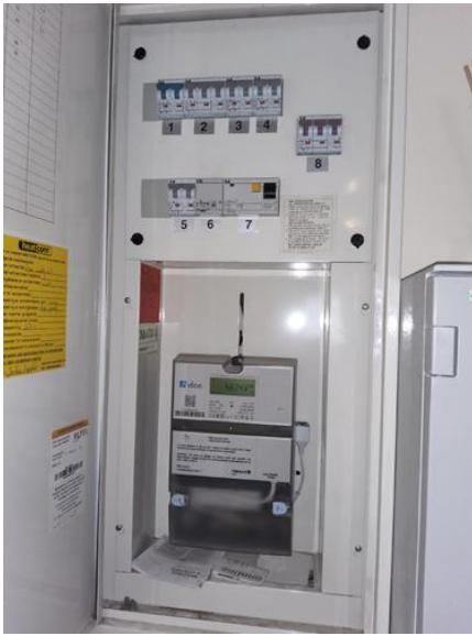
Elektrisk anlegg - [Sikringskap ]
