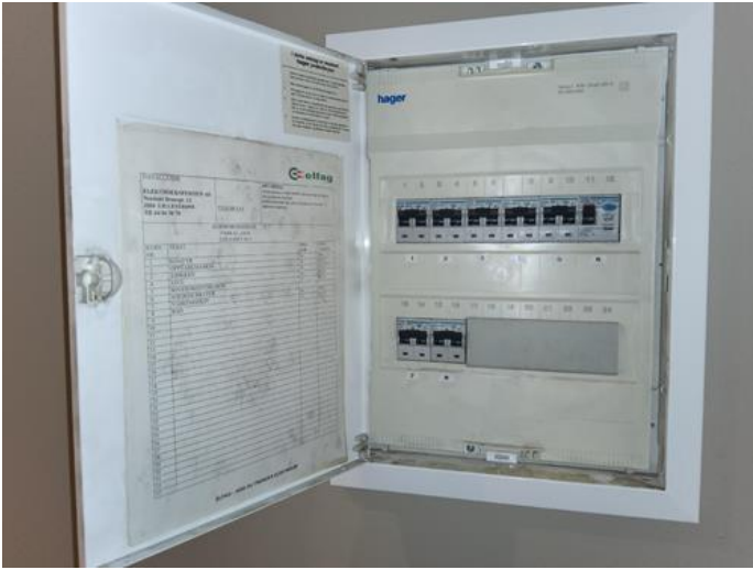
Beskrivelse - [Sikringskap med kursfortegnelse.]
