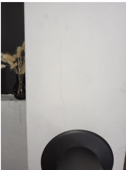
Skorsteiner inne i boligen - [Riss/sprekker påvist på skorstein.]
