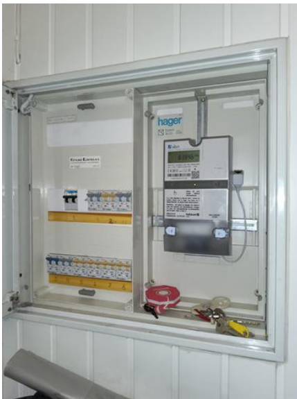
Elektrisk anlegg - [Sikringskap]
