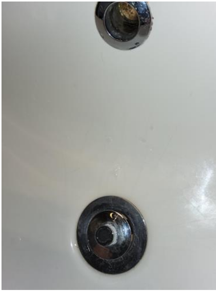
Sanitærutstyr / innredning - [Servant har sprekk/riss i porselen bad]
