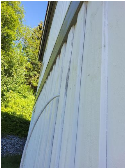
Fasader ink. kledning - [Malings slitasje/manglende dekning på maling yttervegger.]
