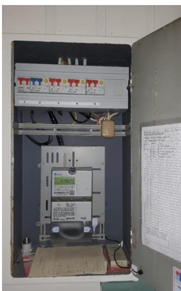
Elektrisk anlegg - [Sikringsskap ]
