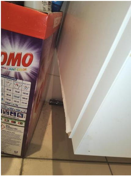
Sanitærutstyr / innredning - [Fuktskader på servantskap.]
