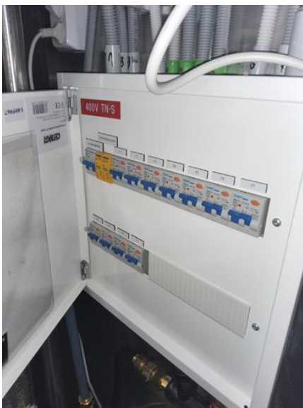
Elektrisk anlegg - [Sikringskap]
