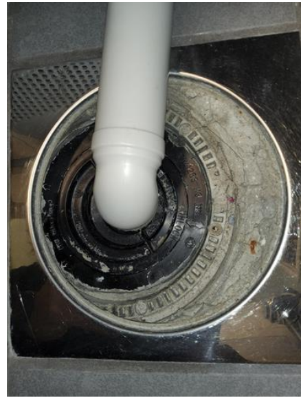
Tekniske anlegg, VVS anlegg (Sjekkpunkter utover det som er inkludert i andre rom) - [Sluk teknisk rom ]
