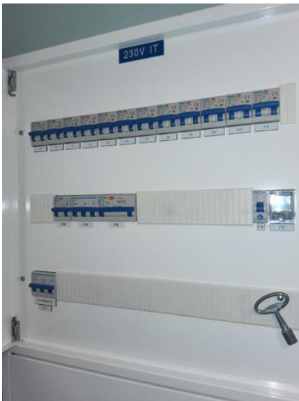
Elektrisk anlegg - [Sikringskap ]
