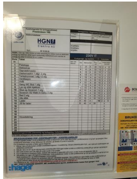
Elektrisk anlegg - [Kursoversikt sikringskap ]
