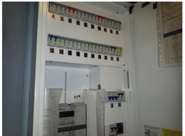
Forenklet vurdering av det elektriske anlegget - [Sikringskap.]
