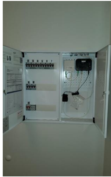
Elektrisk anlegg - [Sikringskap ]
