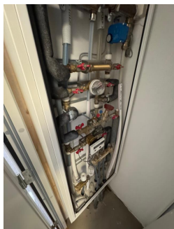
Rørfordelingskap på fellesområder
