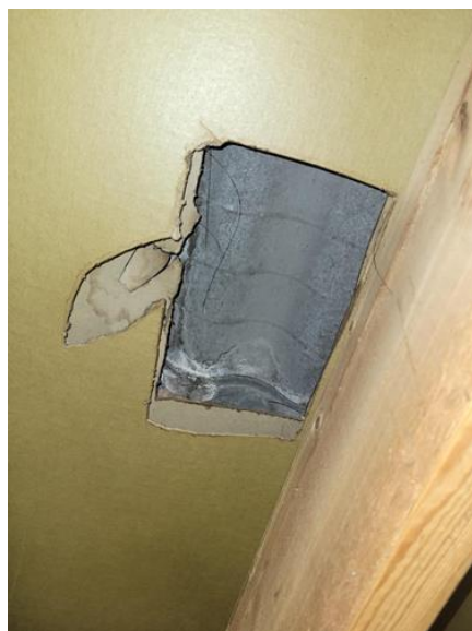
Kommentar - [Utettheter i undertak, råloft ]
