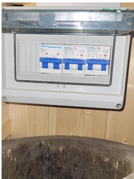
Beskrivelse - [Sikringsskap, garasje]
