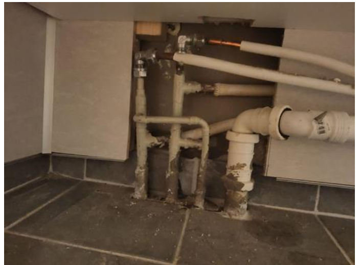
Kommentar - [Åpninger i veggkonstruksjonen bad kjeller ]
