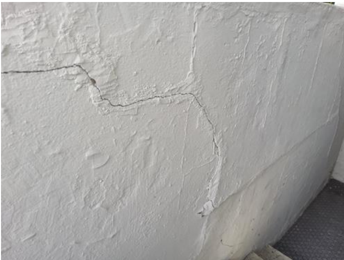
Kommentar - [Sprekke støttemur ved kjellerinngang ]
