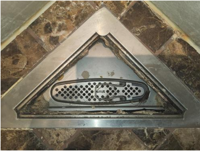
Kommentar - [Sluk bad 1.etasje ]
