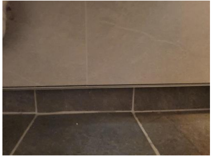
Kommentar - [Manglende fuging under våtromsplater bad kjeller ]
