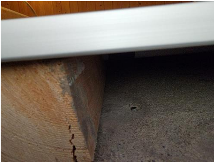
Kommentar - [Manglende tettesjikt ved våtromsplater bad kjeller ]
