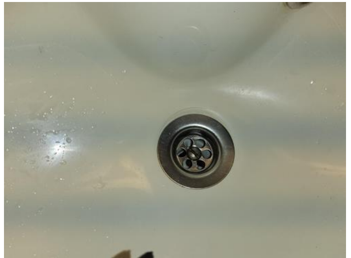
Kommentar - [Sprekk i porselen]
