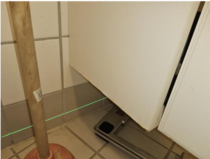
Kommentar - [Svelleskader servantinnredning ]
