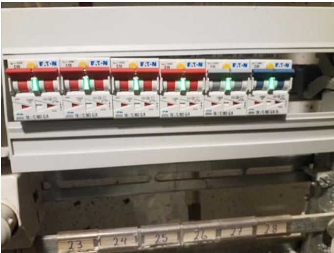
Elektrisk anlegg - [Sikringskap.]
