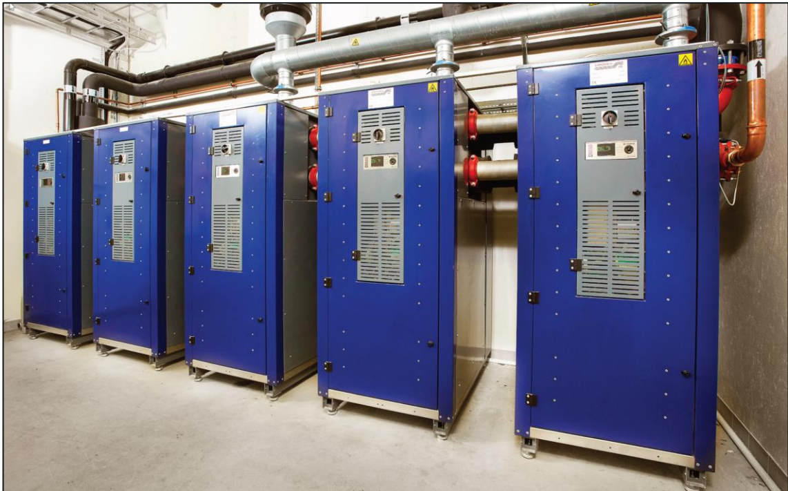
Bilde 04. Varmepumper i paralell tilkobling fra Enrad.
