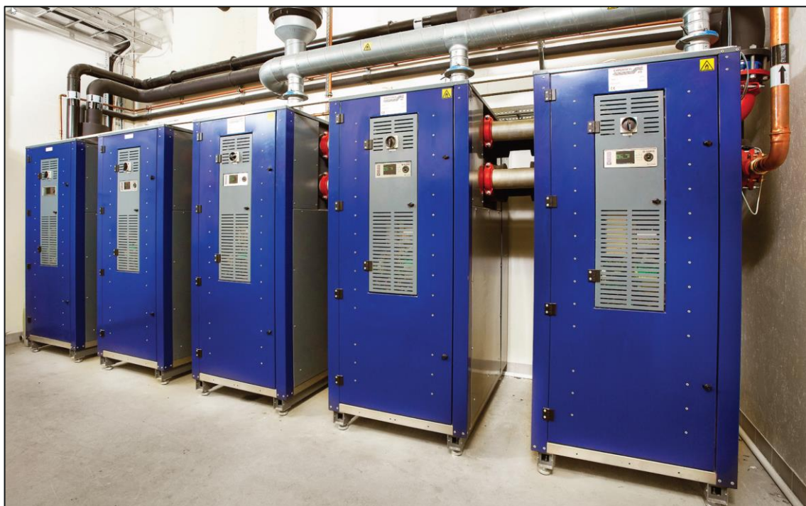
Bilde 04. Varmepumper i parallell tilkobling fra Enrad.
