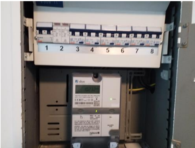
Elektrisk anlegg - [Sikringskap. ]
