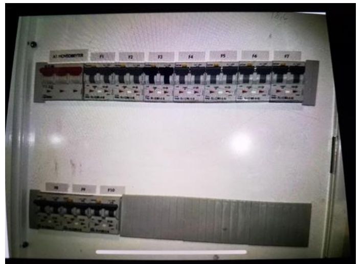
Kommentar - [Sikringskap. Tilleggsdel.]
