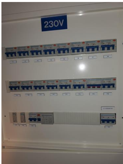
Elektrisk anlegg - [Sikringsskap]
