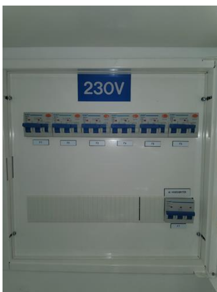
Elektrisk anlegg - [Sikringsskap]
