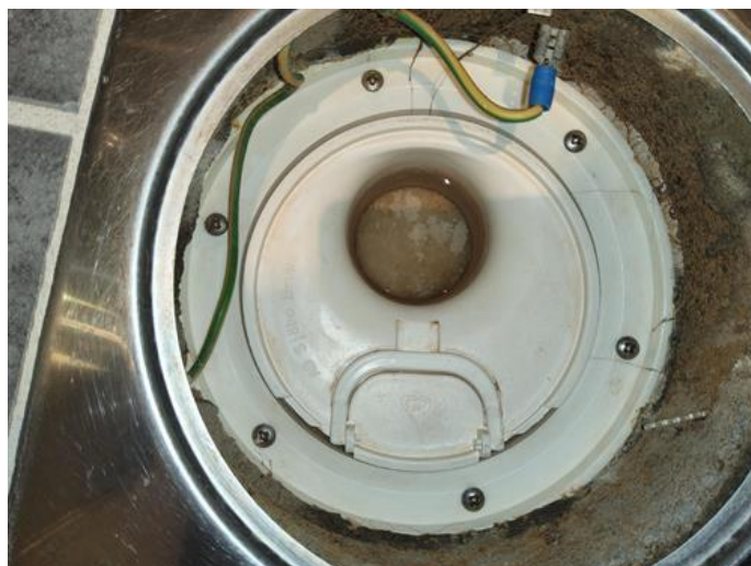
Kommentar - [Sluk bad 1.etasje]
