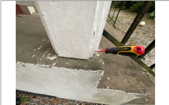
Råte i utendørs tresøyle ved inngangsparti.
