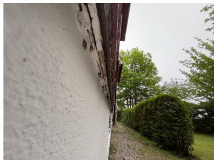
Ingen lufting av yttervegg konstruksjonen.
