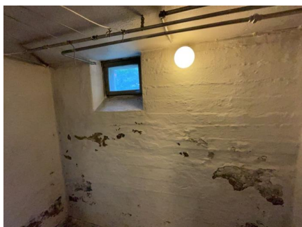
Grunnmur. Synlige merker etter forskaling.
