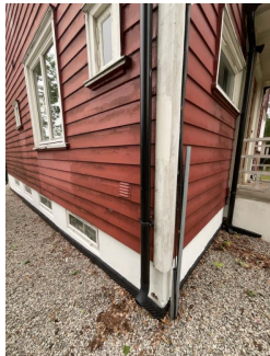
Taknedløpet må ledes lenger vekk fra grunnmur.
