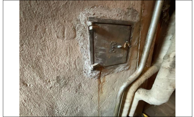
Drypp fra feieluke i pipe på loft.
