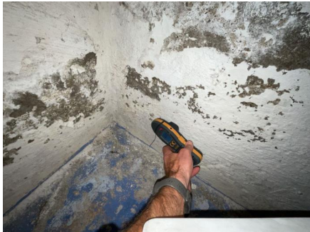
Protimeter fuktutslag gjorde utslag flere steder i kjeller. Synlig saltutslag og avskalling av grunnmur.
