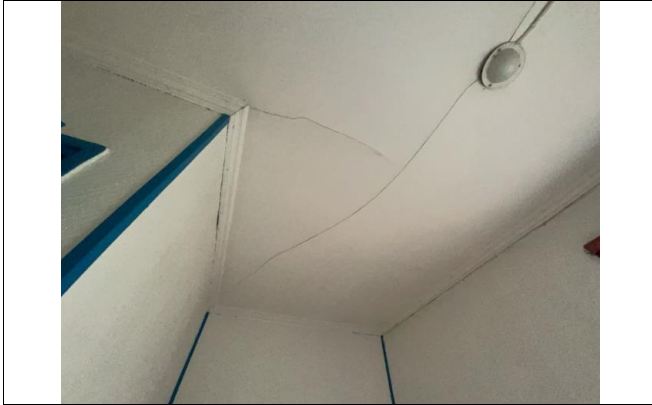
Sprekker i himlingsflate over trapp i 2.etg.
