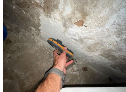
Protimeter fuktutslag gjorde utslag flere steder i kjeller. Synlig saltutslag og avskalling av grunnmur.
