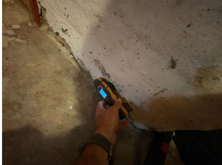
Protimeter fuktutslag gjorde utslag flere steder i kjeller.
