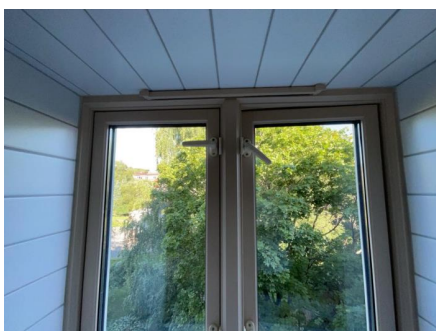
Luftespalte over vindu.
