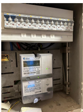
Sikringsskap med automatsikringer.
