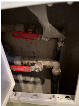
Stoppekraner plassert på soverom
