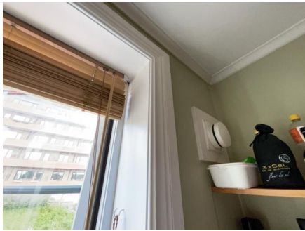
Lufteluke på kjøkken over komfyr.
