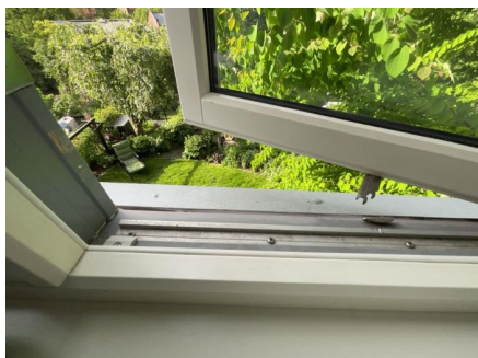
Sikkerhetshaspe er defekt.
