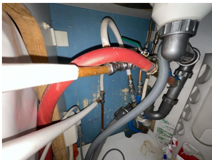
Røropplegg på kjøkken.
