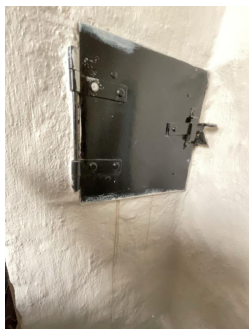
Dryppmerker under feieluke på loft.
