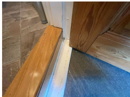
Ikke luftespalte mellom dørbblad og dørterskel.
