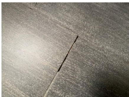
Gulvfliser på kjøkken. Sprekker i sementfuger mellom flisene.
