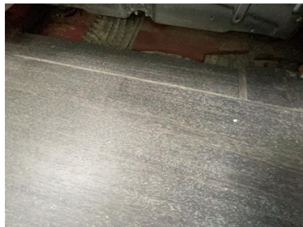
Ikke flislagt under kjøkkeninnredning.
