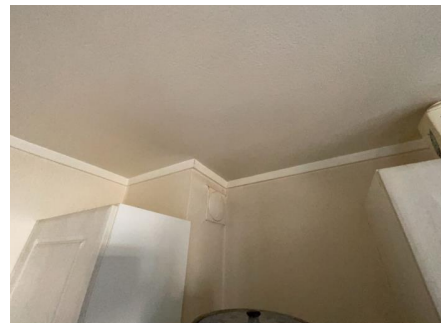
Det er en lufterventil i sjakt i rommet.
