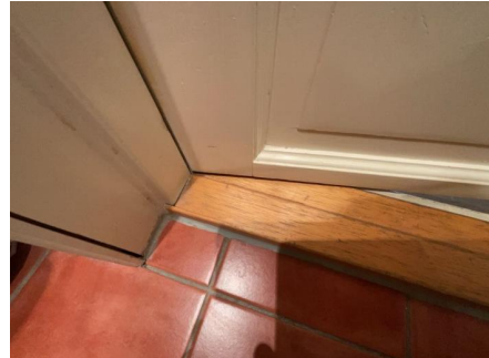
Det mangler tilfredsstillende luftespalte under dørbladet.
