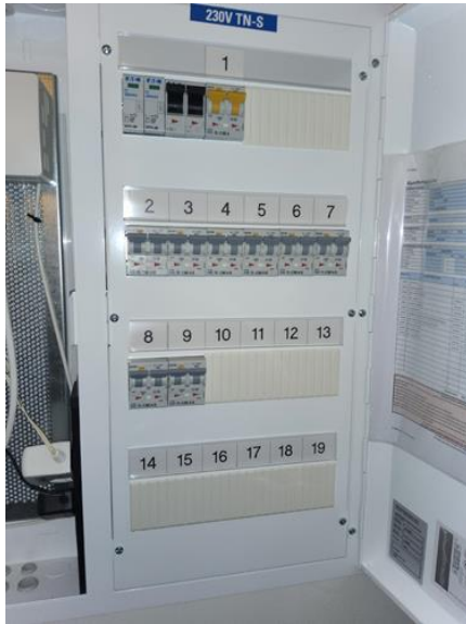
Elektrisk anlegg - [Sikringskap]
