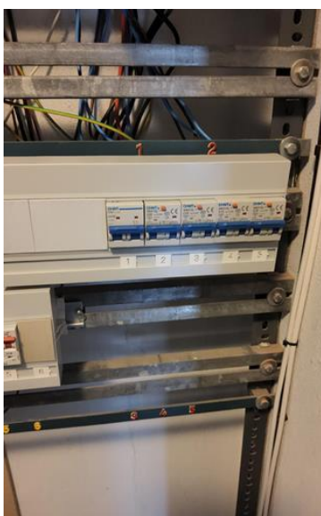
Elektrisk anlegg - [Sikringer]
