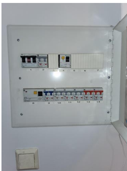
Elektrisk anlegg - [Sikringsskap ]
