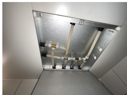
Fordelerskap i himling på badet.
