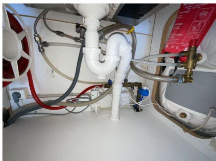
Rør på kjøkken. Lekkasjestopper.
