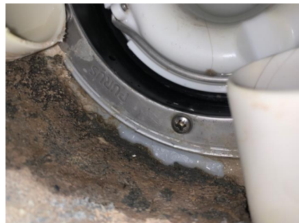
Synlig banemembran i sluket
