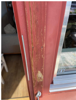
Trenger noe utvendig overflatebehandling på enkelte plasser
