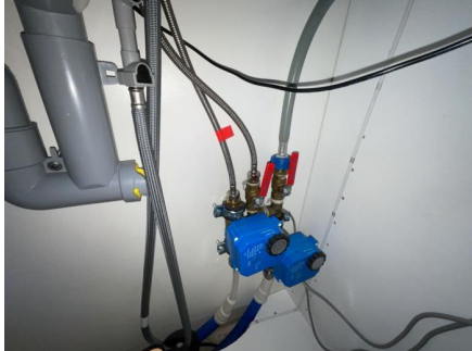
Lekkasjestopper på kjøkken.
