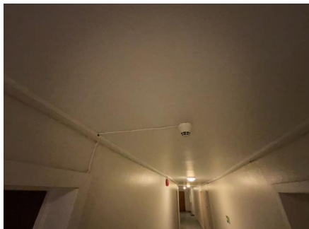
Felles brannvarsler i fellesgangen.
