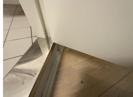
Luftespalte under dørbladet.
