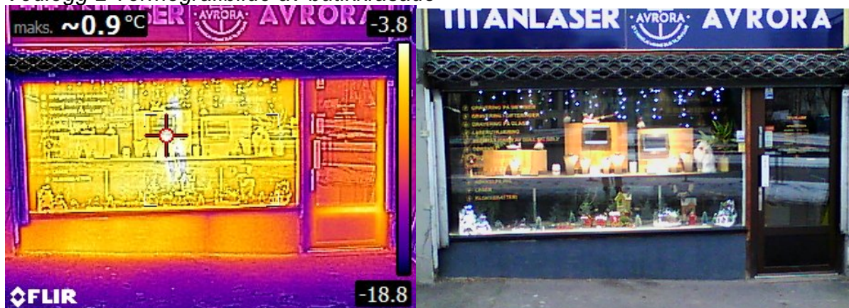
Vedlegg 2 Termografibilde av butikkfasade
