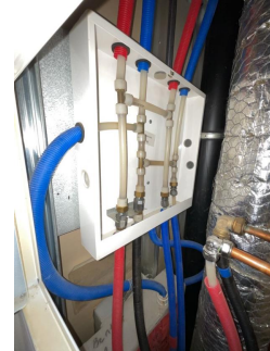
Skap med rør innenfor inspeksjonsluken.
