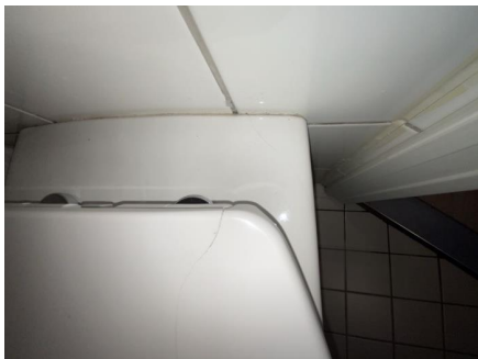
Sprekk i toalettsete og toalettsskål.
