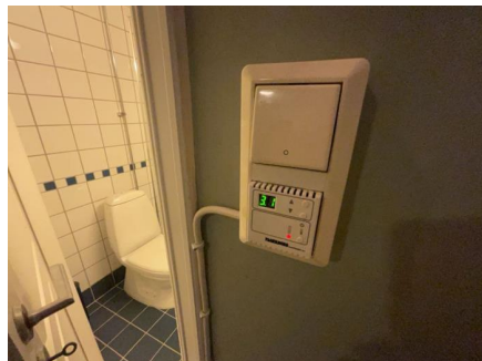
Termostatbryter til varmekabler.
