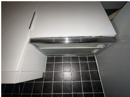
Ventilator med kullfilter.
