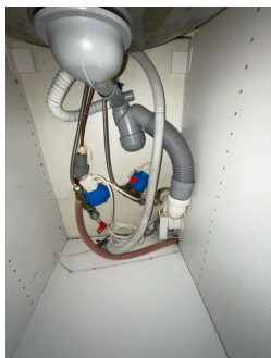
Rør og lekkasjestopper på kjøkken.
