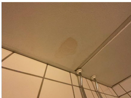
Skjolder i himlingsplate.
