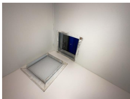
Små sprekker rundt luken.
